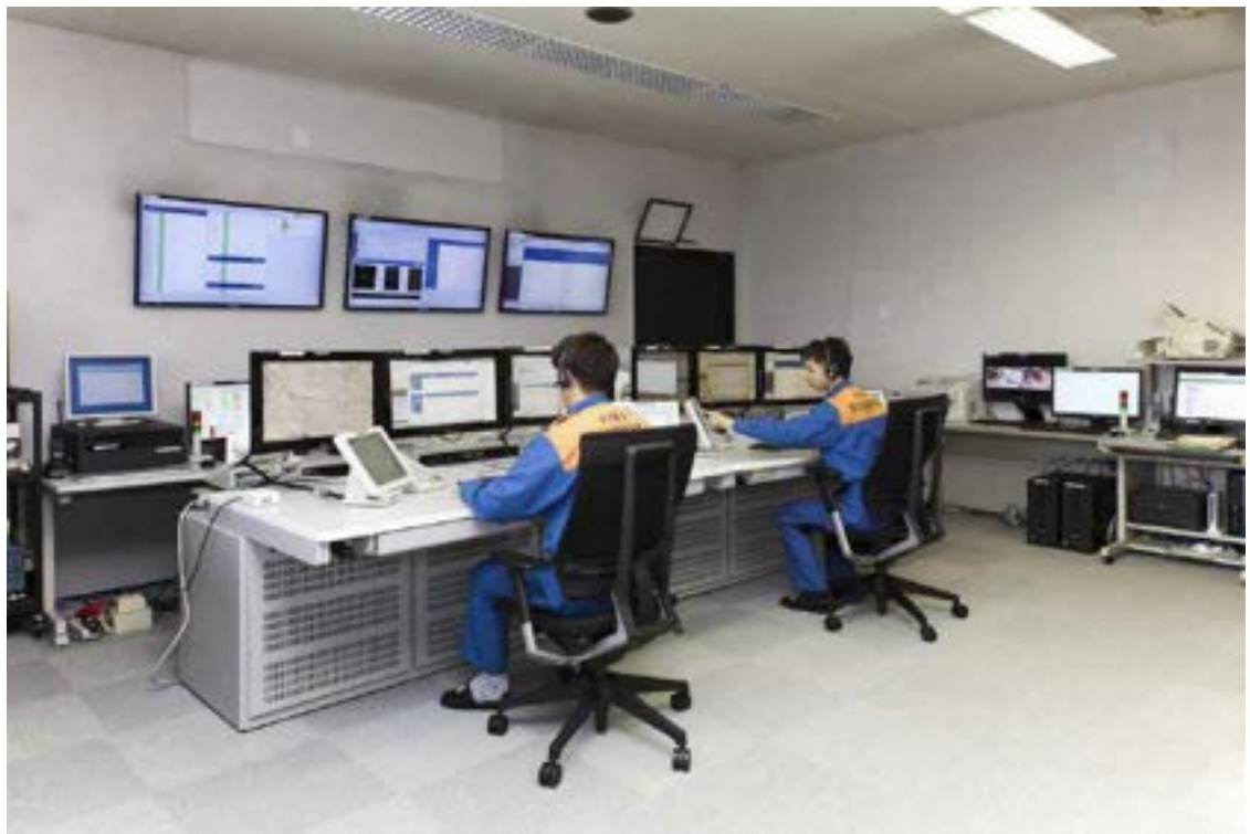
高機能消防指令システム
